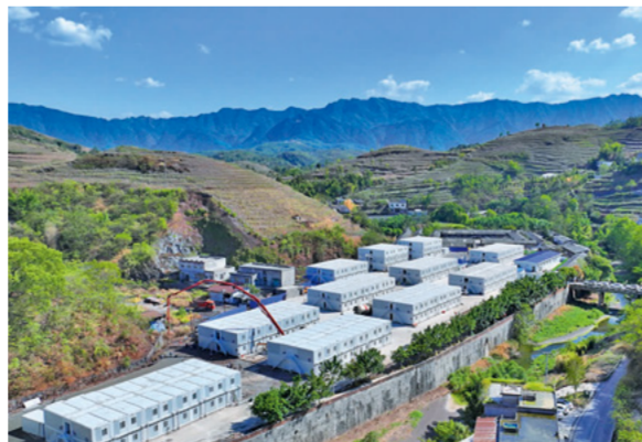
9月6日，南方公司宜宾兴文县方舱隔离点工程完工交付，该项目总占地面积15万平方米，新建方舱隔离病房420间，投入使用后将提高兴文县应对新冠肺炎疫情防控和处置能力，完善兴文县疫情防控体系，对当前应对疫情反弹起到重要作用，有效保障当地人民群众生命健康。图/文 刘璐 熊浩
